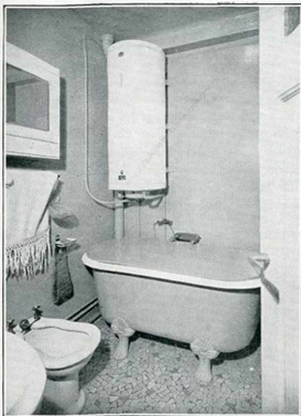
Fig. 2. — Cet appareil, du type mural, d'une capacité de 100 litres alimente la baignoire et les deux autres postes d'eau de la salle de bains.
